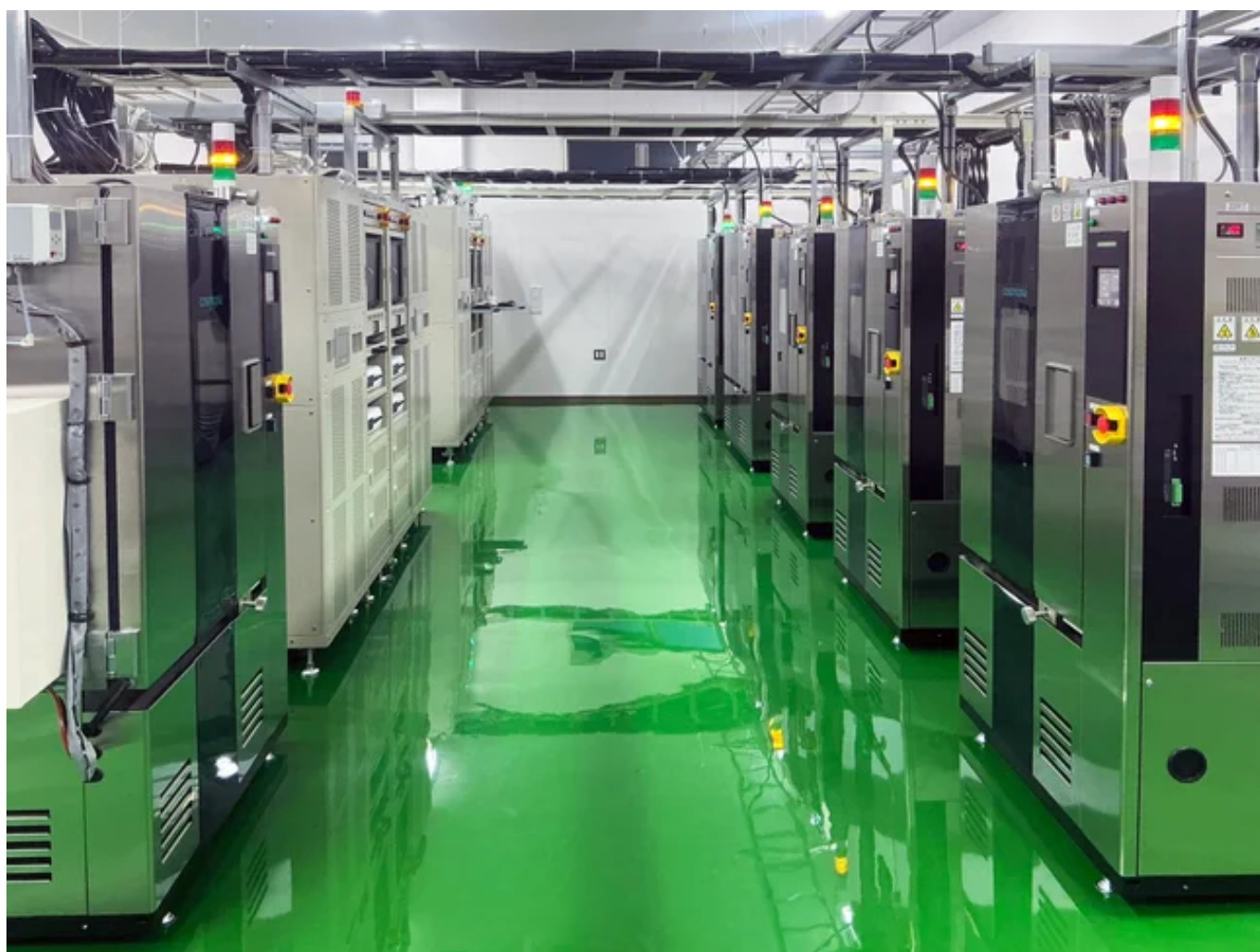
充放電試験室
