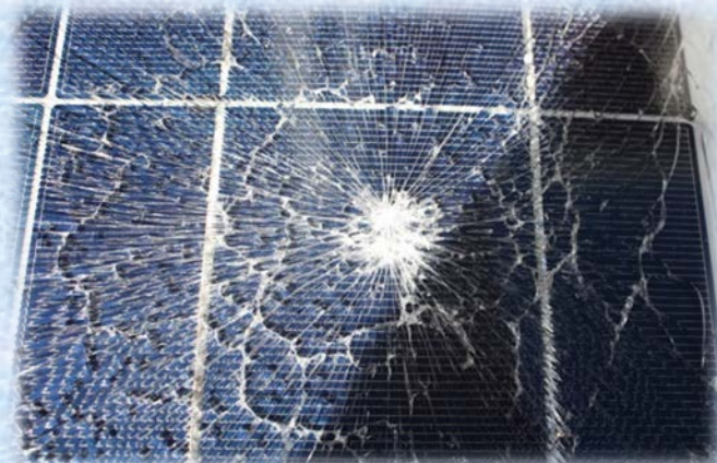
モジュールガラス割れ事例
