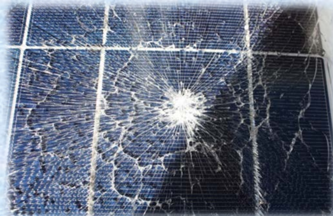
モジュールガラス割れ事例
