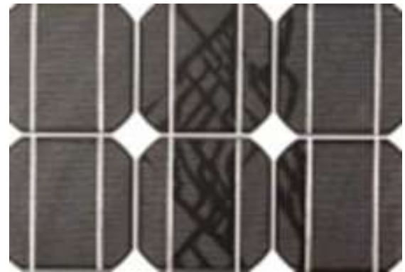
スネイルトレイルが発生した太陽電池モジュール
