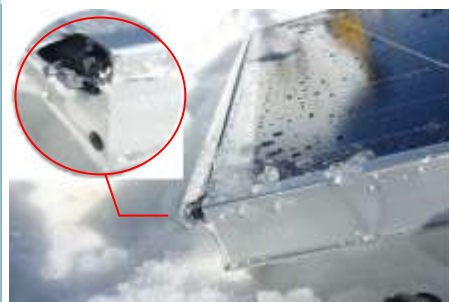
積雪によるフレームの破損
