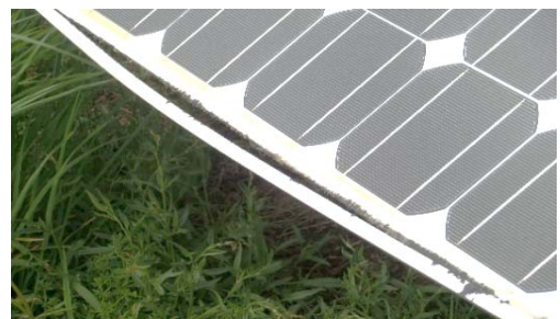
2014年2月山梨の大雪により変形したフレーム
